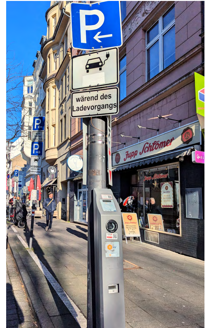
Straßenlaterne mit Lademöglichkeit auf der Neusser Straße in Köln
